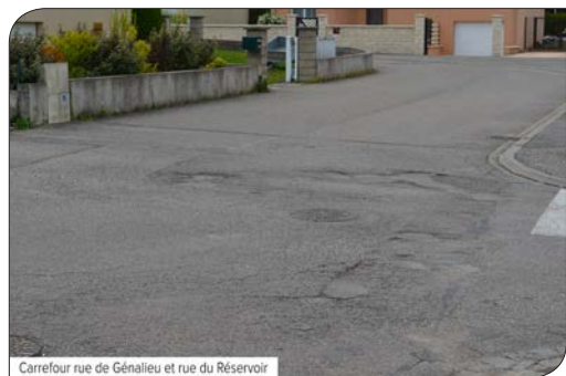
Carrefour rue de Génalieu et rue du Réservoir
